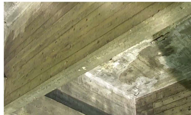
Rilievo visivo di difetti
